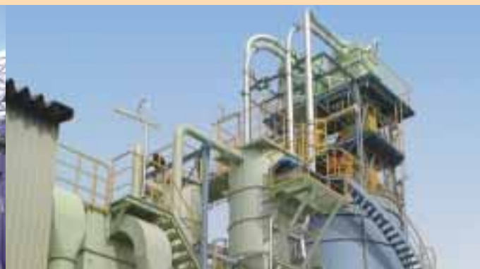
廃棄プラスチック処理設備
