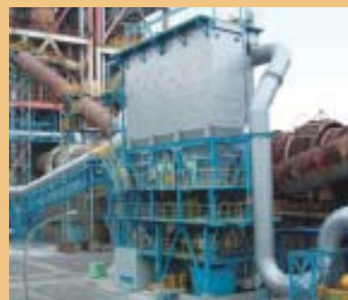
高塩素バイパス設備
