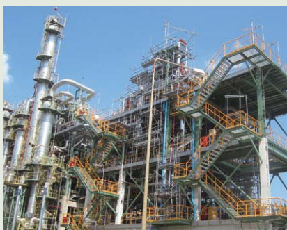
2015年10月に稼働開始した タイのPCDプラント
