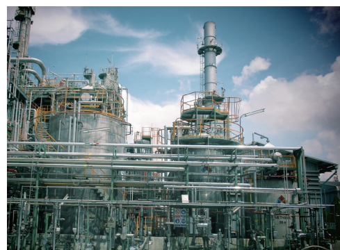
タイで稼働中のPCD製造設備(Ⅰ期・Ⅱ期)
