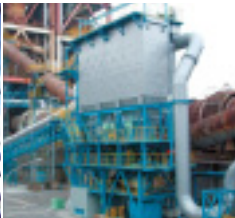
[苅田セメント工場 塩素パイパス]
