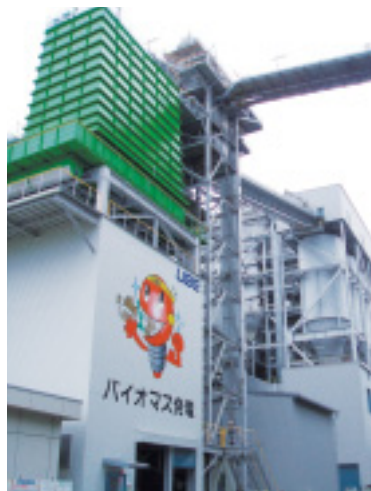
216MW(IPP)発電所 バイオマス燃料化設備
