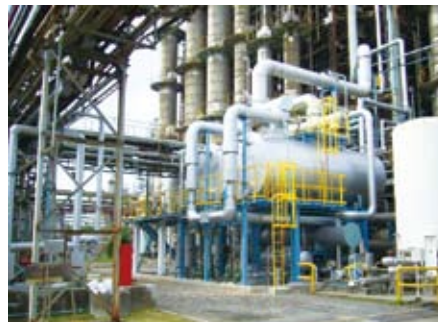
シクロヘキサン回収設備(宇部ケミカル工場)
