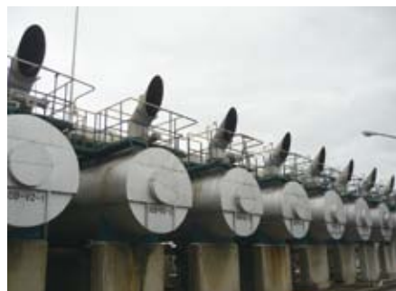
脱臭設備(千葉石油化学工場)
