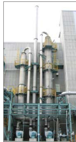
VOC 排出除外設備(堺工場)
